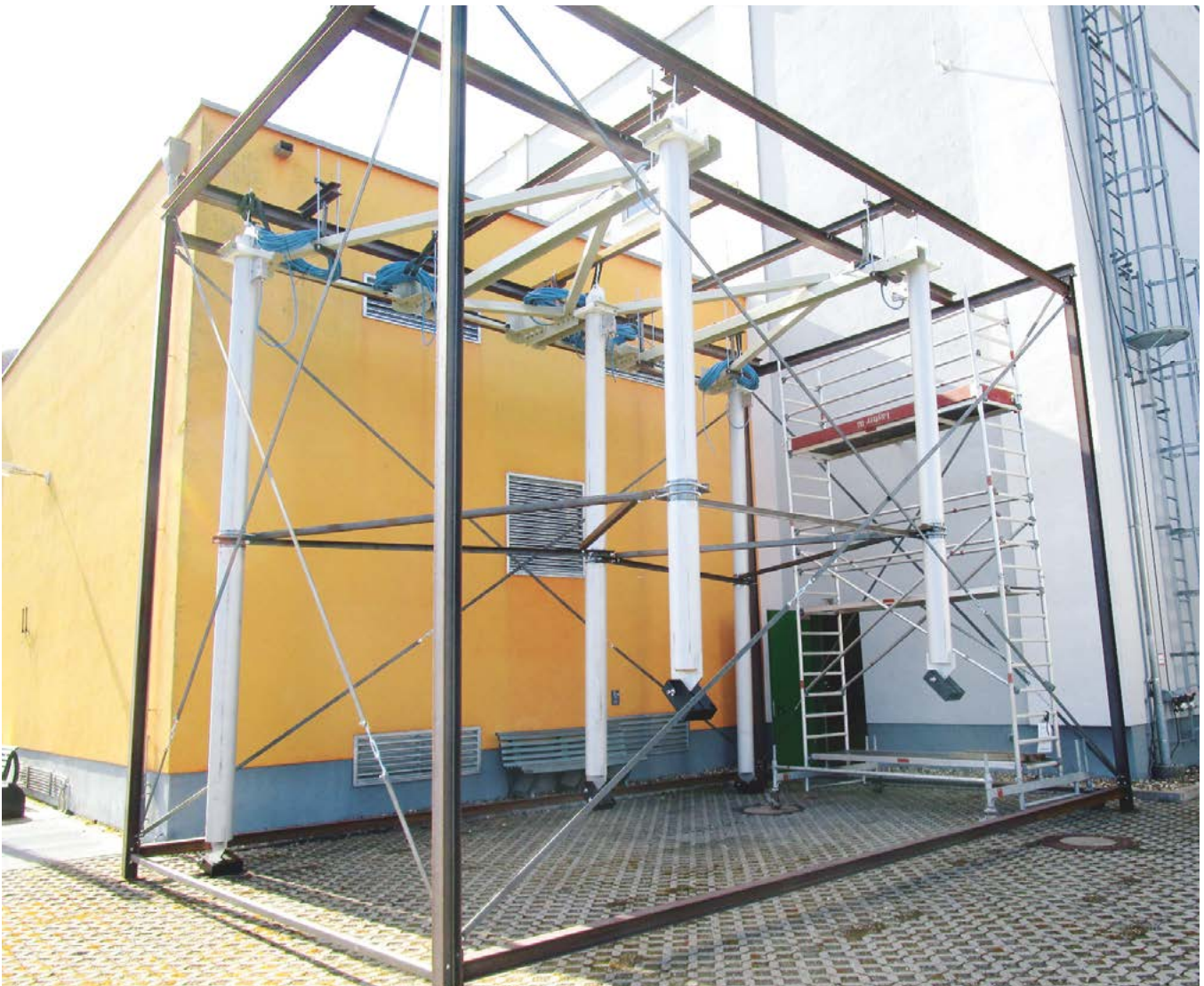
Elektrische Fisch-Scheuchanlage vor dem Einbau
