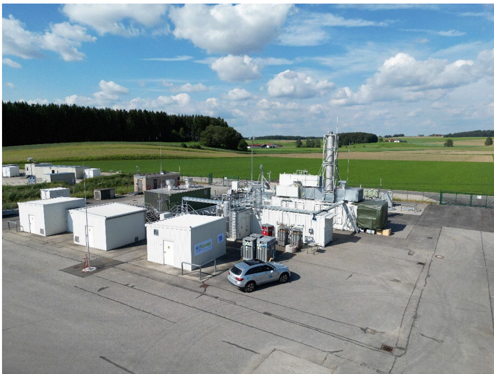
Auf dem Bohrplatz BW B6 am Speicherstandort Bierwang wird das Forschungsprojekt HyStorage durchgeführt. (Quelle: Uniper Energy Storage)
