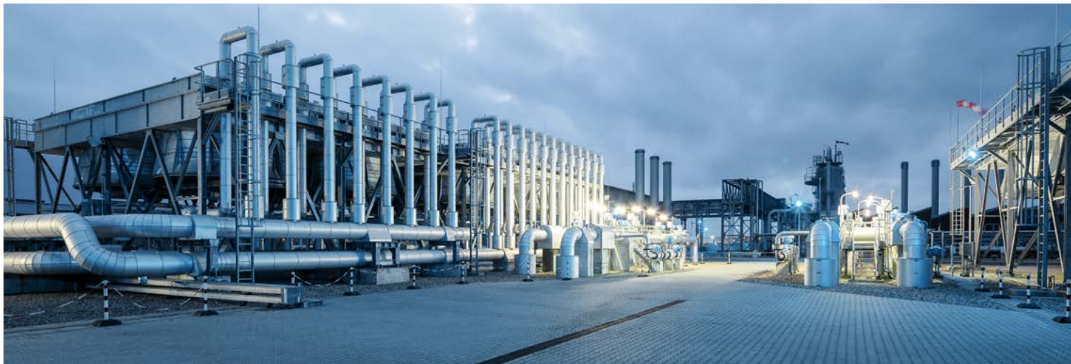
Gaspeicheranlage in Etzel, Deutschland, bei Nacht.
