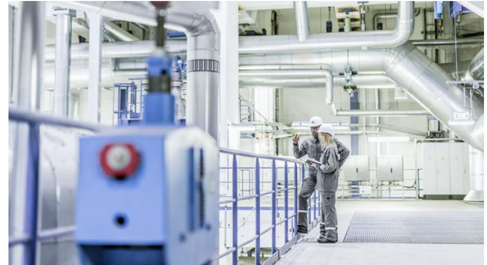
Uniper-Mitarbeiter im Kraftwerk Maasvlakte, Niederlande.
