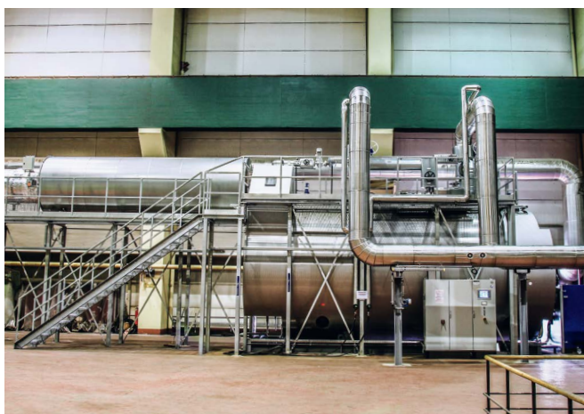
Gasgefeuerter Heißwassererzeuger im Altkraftwerk Datteln
