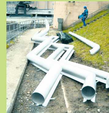
Zick-Zack-Rohr zur abwärtsgerichteten Wanderung von Fischen in Rothenfels
