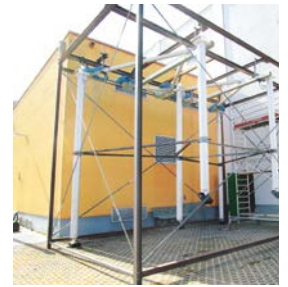
Elektrische Fisch-Scheuchanlage vor dem Einbau
